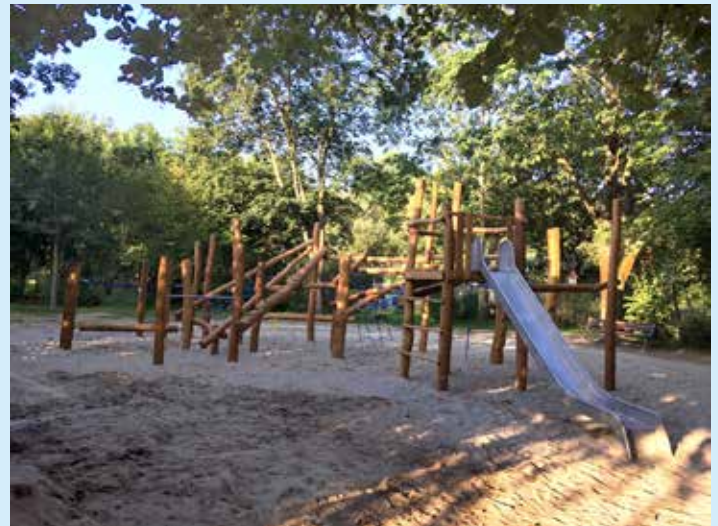
Zur Freude von Kindern und Eltern wurde in den Sommerferien der Ebnetter Spielplatz von Grund auf saniert.
